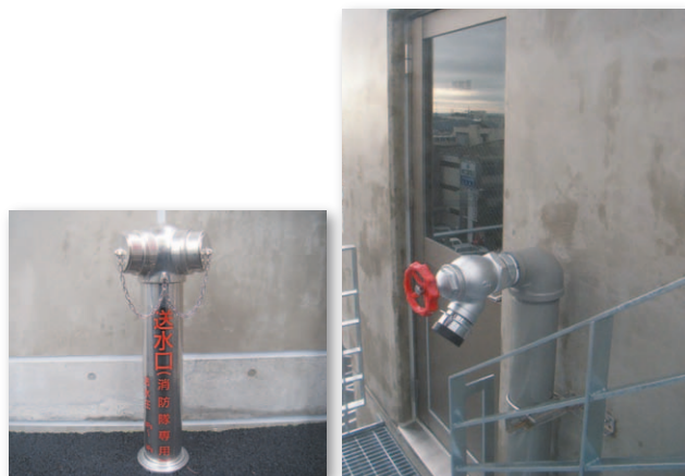
連結送水管訓練場
