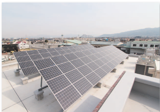
太陽光発電設備
