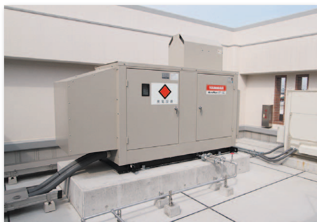
自家発電設備
